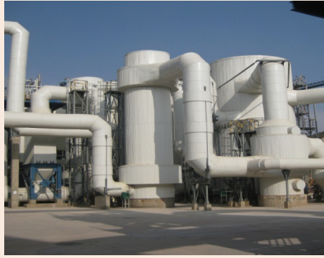
制酸系统热交换与转化设施
