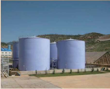
硫酸贮罐区及备用罐区
