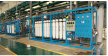
驰宏综合利用动力厂化学水处理站
