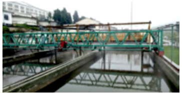
驰宏会泽矿业选矿厂回水系统
